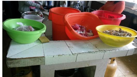
Köksbänk i behov av renovering
